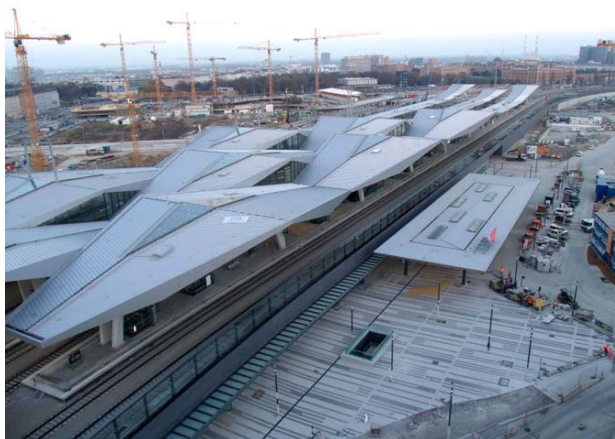
Hauptbahnhof Wien, Vorbereitungen für den Teilbetrieb; das Dach ist „burgenländisch“ (Stahlbau Unger, Oberwart)
